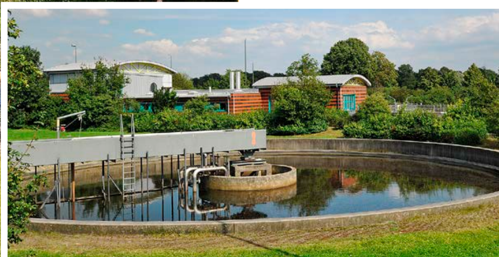
Die Kläranlage Dülmen hat bereits eine 4. Reinigungsstufe. Sie filtert Spurenstoffe effizient aus dem Klärwasser.
