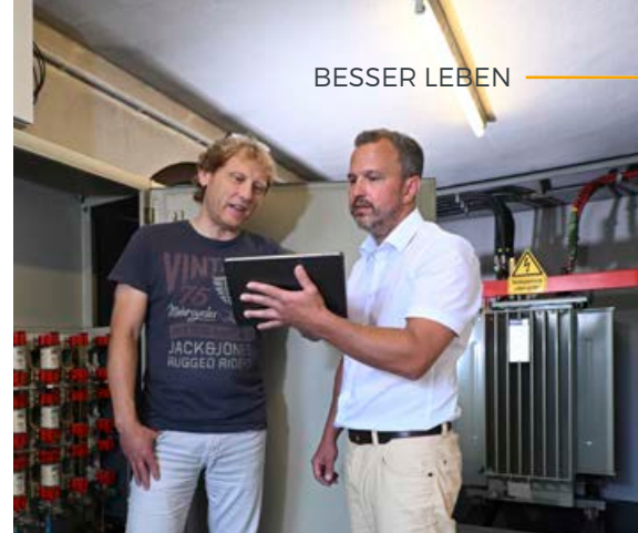
Die Auslastung dieser Trafostation können Marco Netz (r.) und Thomas Knels in Echtzeit verfolgen.
