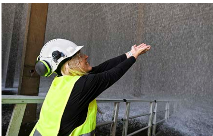
80.000 Kubikmeter Wasser sind im Kühlturm im Umlauf. Das Wasser fällt 178 Meter in die Tiefe – wie ein Regenschauer in XXL!
